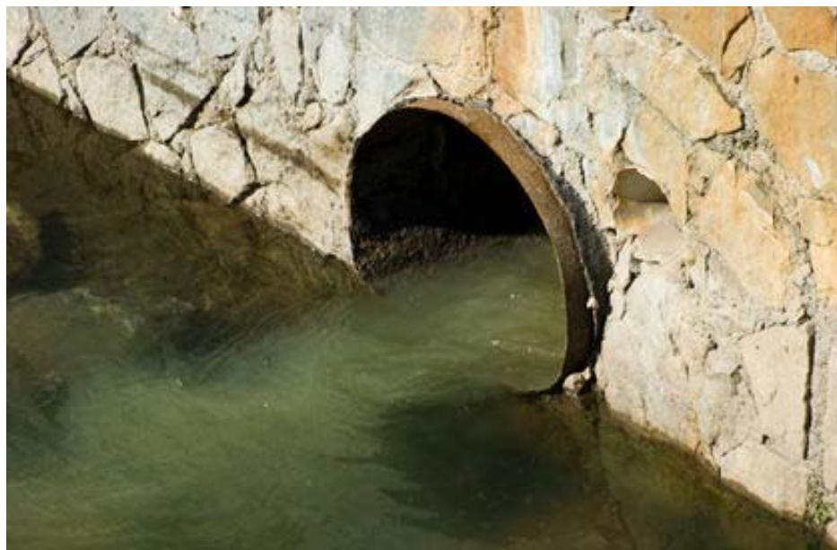
Slika 40. Nekontrolirano ispuštanje nepročišćenih otpadnih voda u okoliš 106
