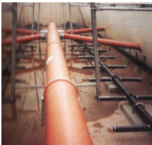
Slika 47. Aeratori na dnu biološkog reaktora
