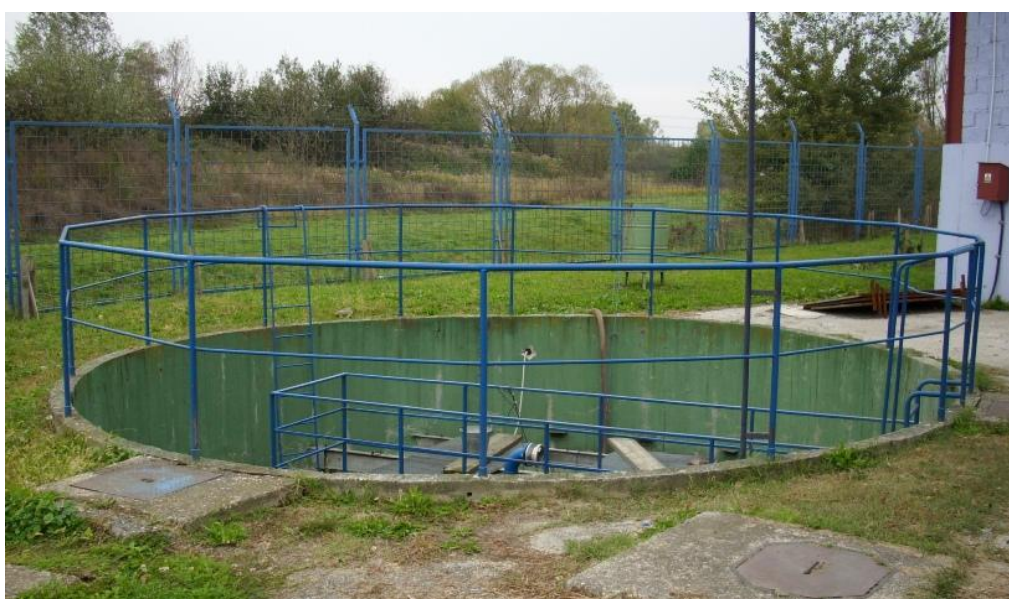
Slika 39. Biološki bazen u ljevaonici Lipovica d.o.o.
